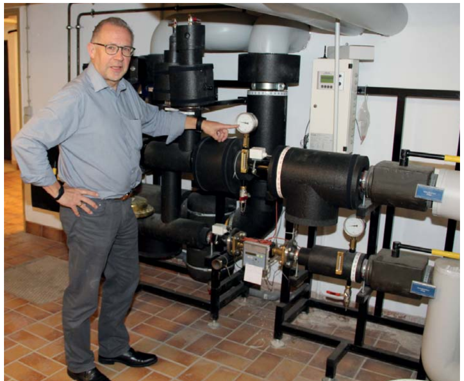
Heimleiter Klaus Müller zeigt die Übergabestation, an der die hauseigene Heizungsversorgung des Altenheims St. Augustin an das Nahwärmesystem angeschlossen ist.
